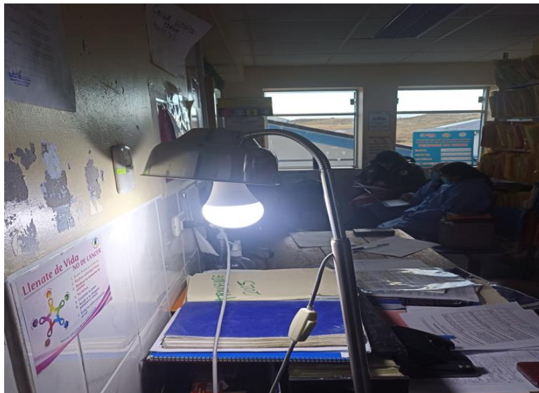
Puesto de Salud Huayhuahuasi (inadecuada conexión eléctrica en ambientes)
